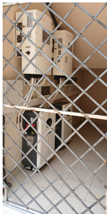
Batterierna som lagrar energin. Foto: Ramo
